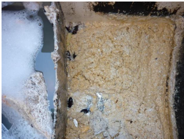
ゴキブリ(油脂上に黒く浮かんでいる)の温床
